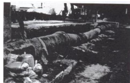
شکل ۸ رفتار مناسب لوله با اتصالات انعطاف پذیر در زلزله کوبه
