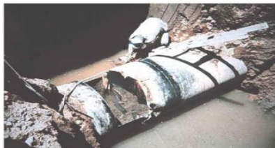
شکل ۶ ساز و کار خرابی لوله در اثر جابجایی خاک مجاور
